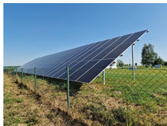
Fot. Instalacja fotowoltaiczna SUW Gniechowice
