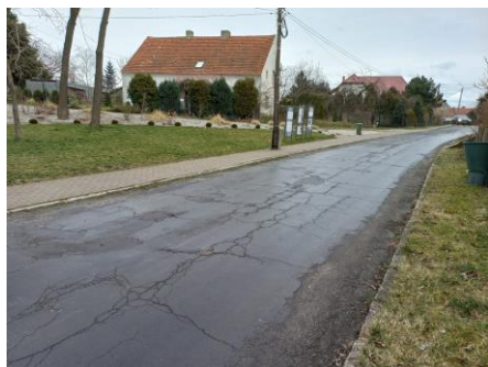
Fot. Droga w ul. Piwnej w Zachowicach przy Skwerze Życzliwości przed remontem
