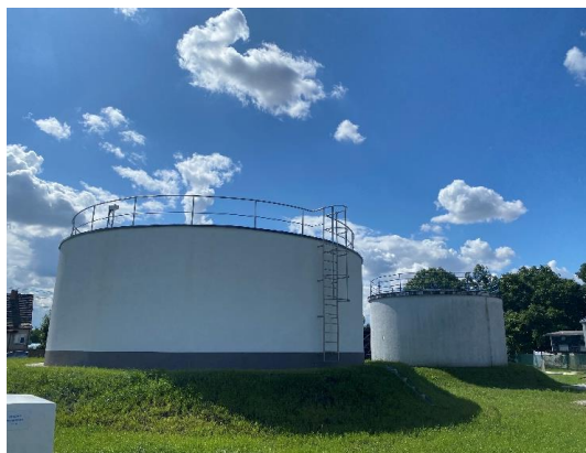
Fot. Zbiornik wody czystej 500m 3 SUW Smolec
