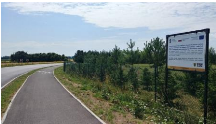
Fot. Droga rowerowa od strony Małkowic: w trakcie robót oraz po wykonaniu prac
