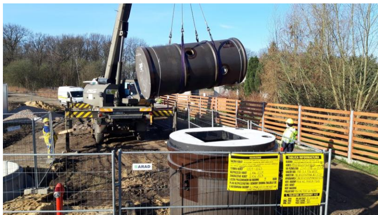
Fot. Kanalizacja sanitarna w m. Smolec w ul. Pogodnej, Parkowej, Rajskiej, Słonecznej, Laurowej
