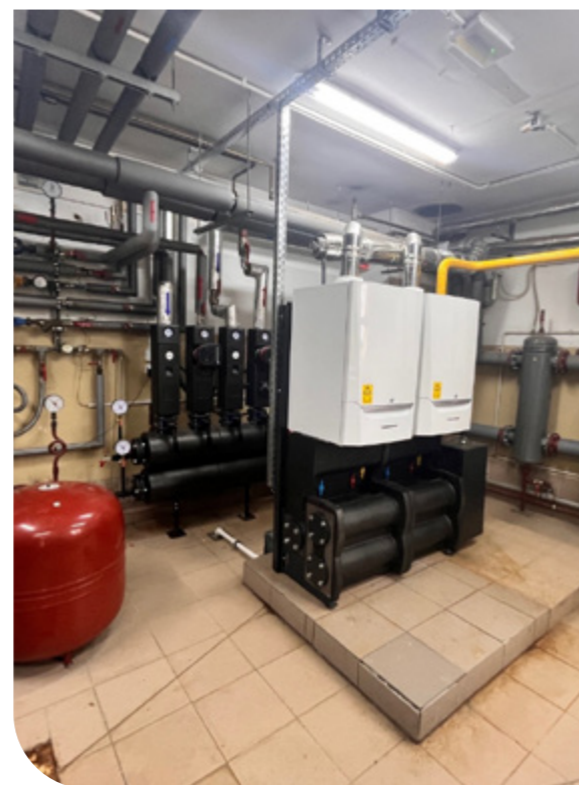
Fot. Kotłownia po przebudowie w SP 1 przy ul. 1-Maja 59
