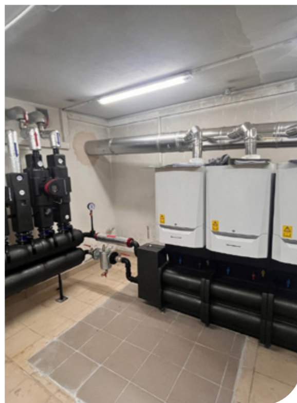
Fot. Kotłownia po przebudowie w SP 1 przy ul. Żeromskiego
