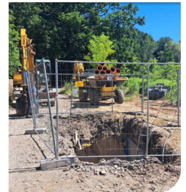
Wykonanie kanalizacji grawitacyjnej w ul. Pogodnej, Parkowej, Rajskiej, Słonecznej, Laurowej i Ładnej wraz z budową przepompowni tłocznej w m. Smolec
