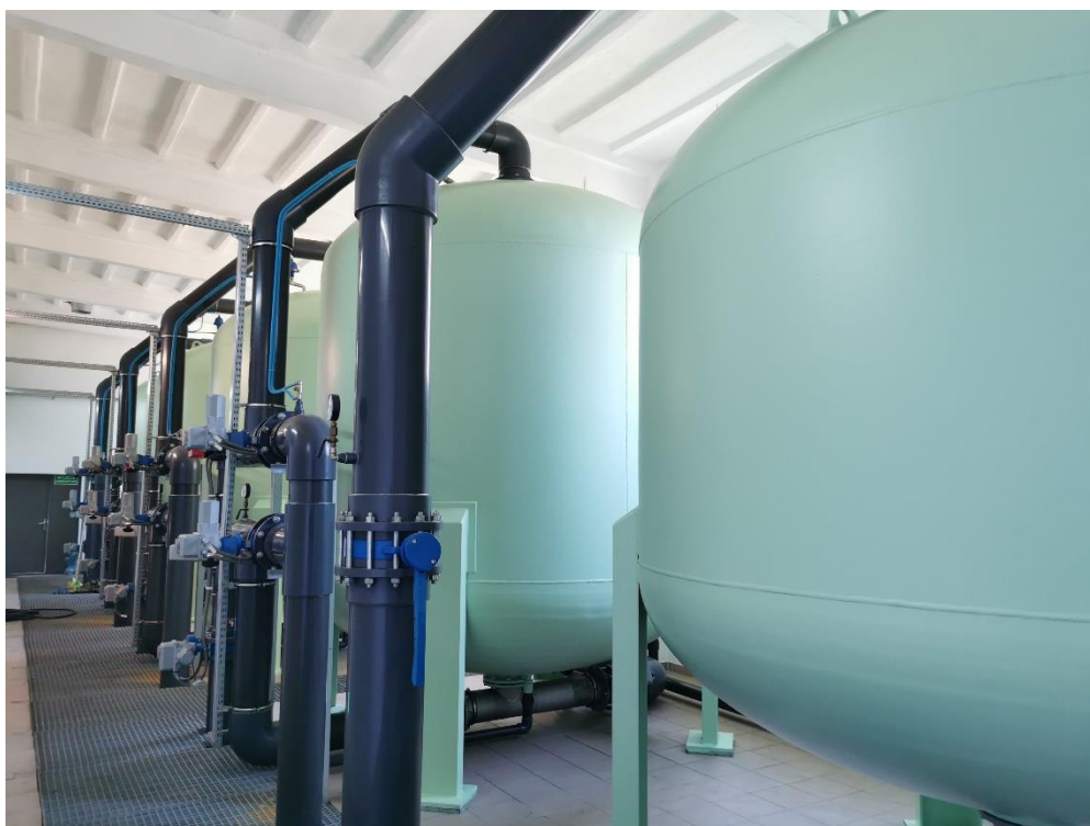
Hala Filtrów SUW Kąty Wrocławskie
